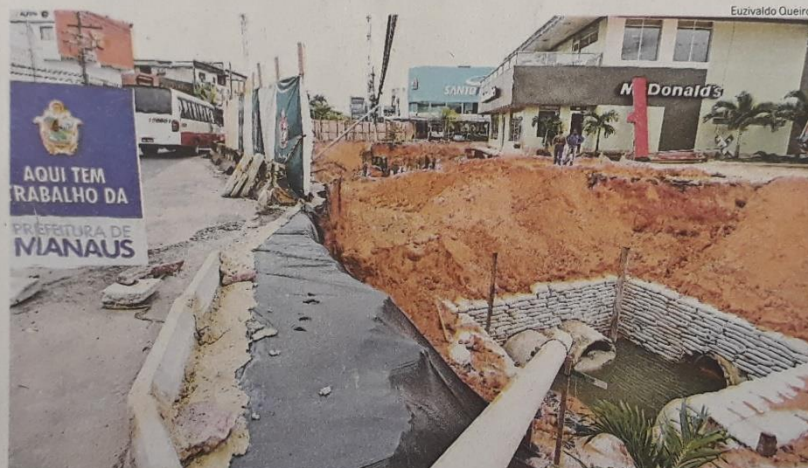
Cratera aberta em dezembro revelou que a rede neste trecho estava comprometida e local está em obras desde março
