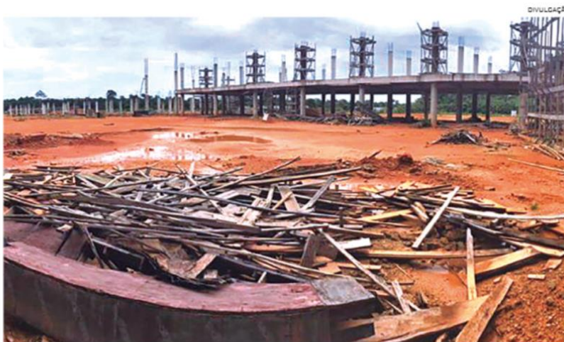
Obras na Cidade Universitária, em Iranduba, estão paradas. Madeiras e concretos estão abandonados pelo
