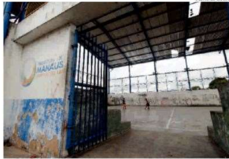
Quando chove o espaço fica inutilizado: ele ataga, pois há várias telhas faltando
