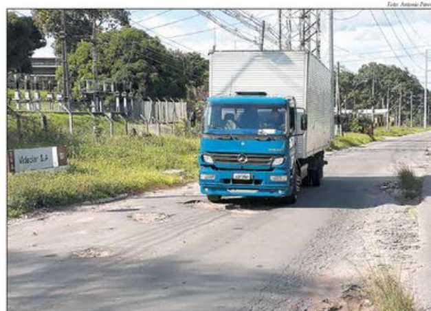
Asfaltamento das vias do Distrito Industrial está em condições precárias há tempos
