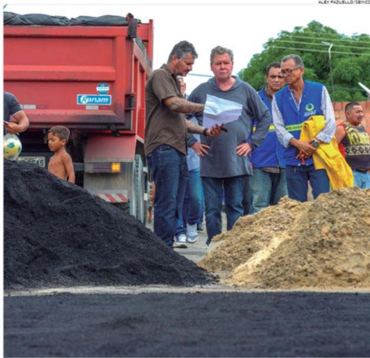
Prefeito Arthur Neto e secretário de Infraestrutura Kelton Aguiar estiveram acompanhando as obras no conjunto Cidadão 9, Zona Leste
