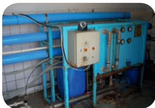
Dessalinizador (osmose reversa) utilizado em poço no aquífero fissural
