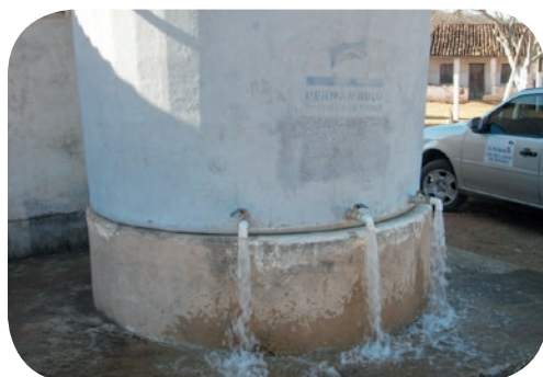
Chafariz de uso coletivo implantado em caixa d'água de PVC
