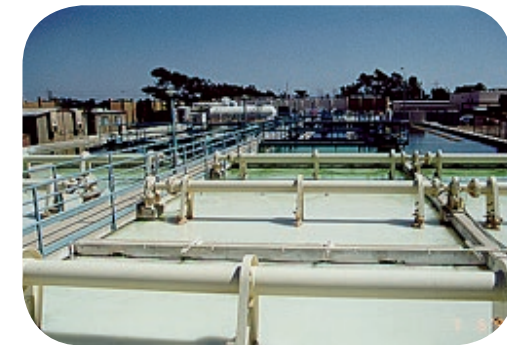
Tratamento de águas servidas para reúso no abastecimento
